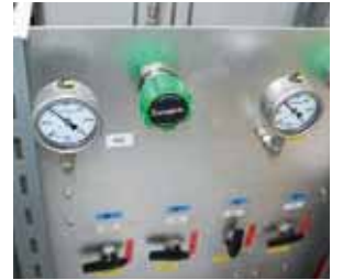
最初に入力したガス分配用パネル
